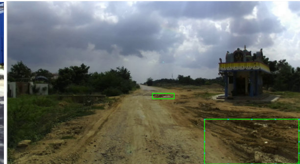
(d) Pothole detection on muddy roads
